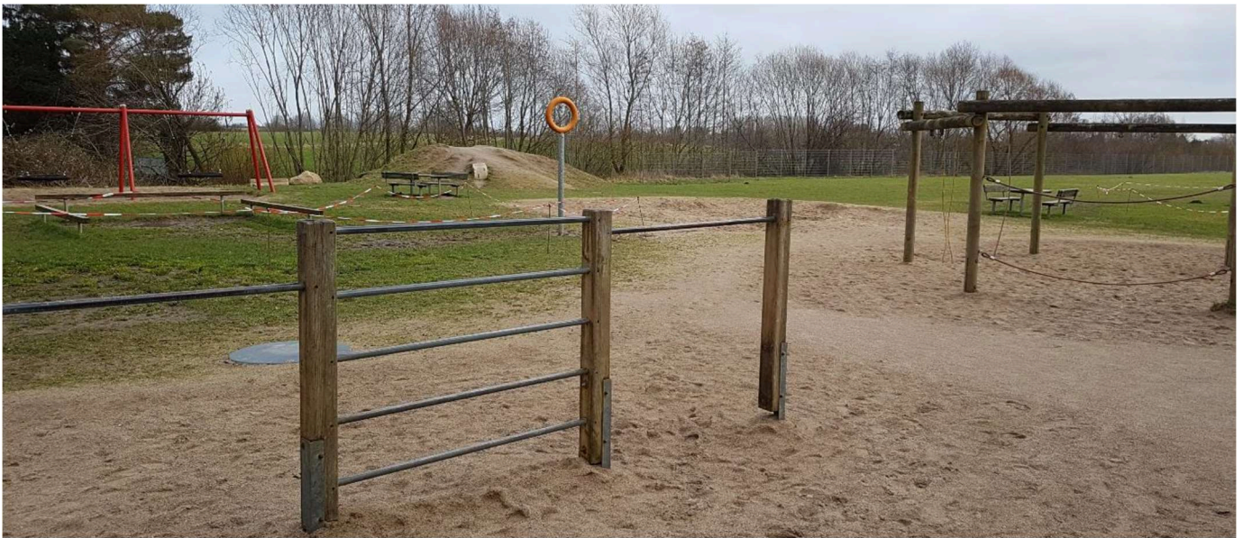
Abbildung 1: Spielplatz im Bestand, die Reckstangen und das Gerüst rechts im Bild sind marode und werden abgerissen
